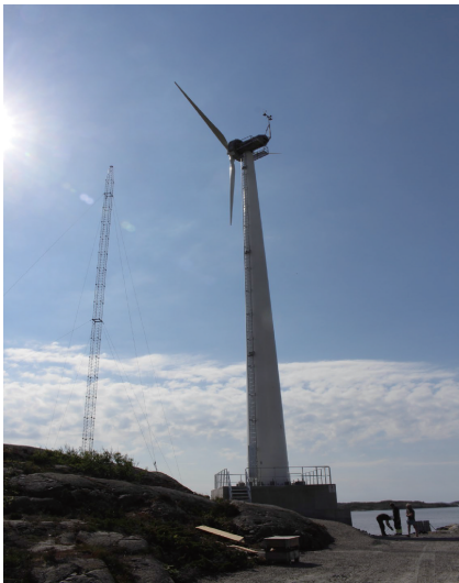
图 1 风电机组现场实拍图 Fig. 1 On-site photo of the wind turbine
