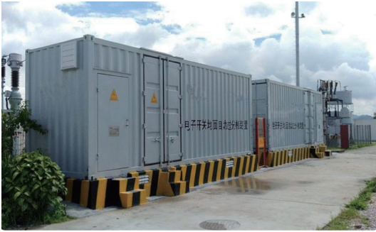
图 13 示范工程设备
